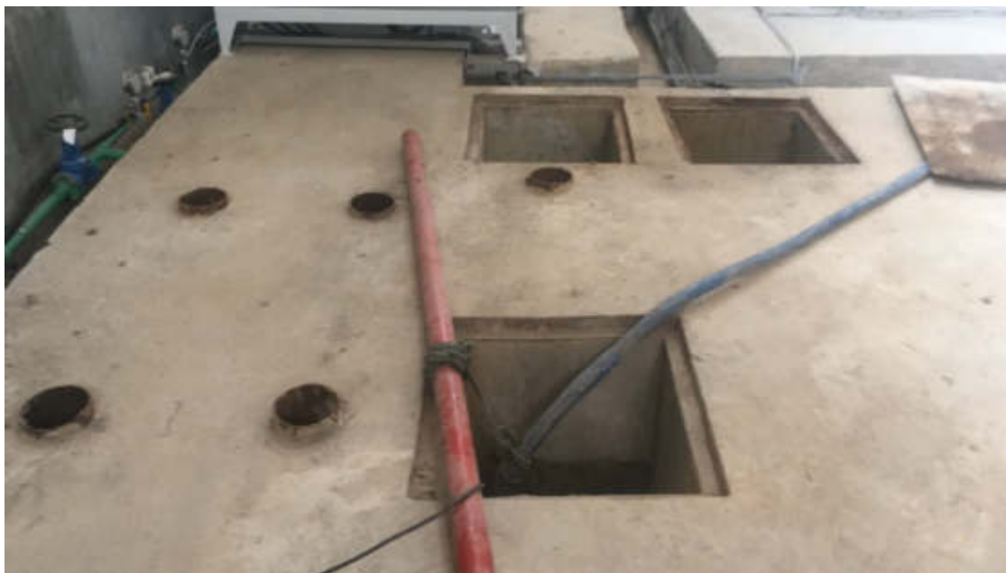
Hình 10. Hình ảnh hệ thống xử lý nước thải sản xuất tại nhà máy
